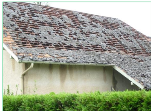
Toiture détruite par la grêle à Ogeu en 2009
