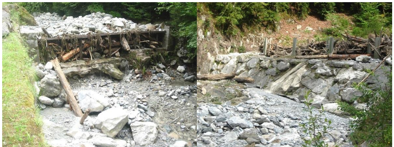
Pièges à matériaux dans le lit du torrent la Sourde (Eaux-Bonnes) crue du 6 août 2009
