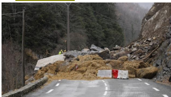
Eboulement en vallée d'Aspe en 2008 © Gilles Daid
