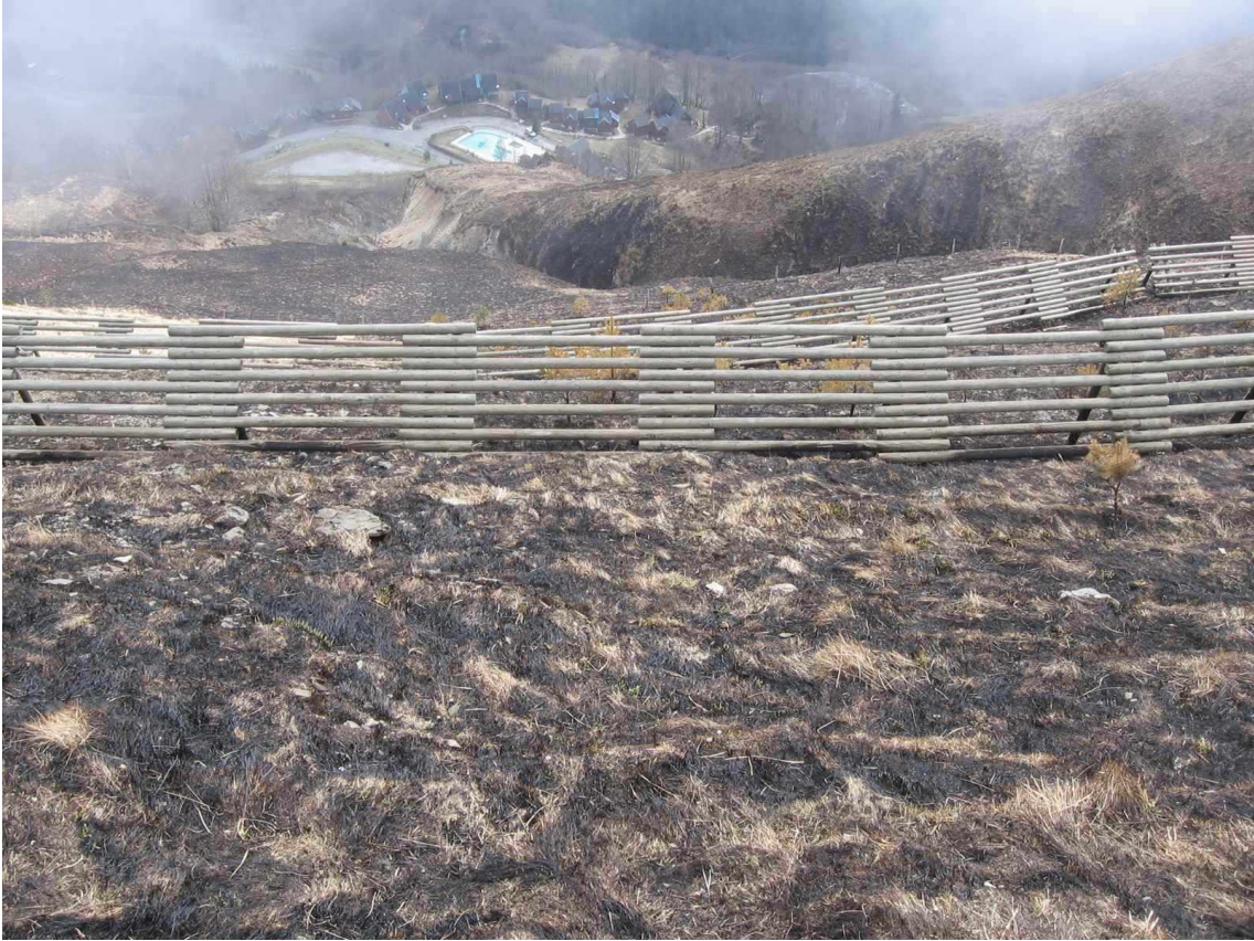
Illustration n°13 : Incendie au droit des claies bois -emprise n°4 - Couloir de Crêtes Blanches Est, CLPA n°2 - Prise de vue mars 2010 - G. Viprey, ONF-RTM
